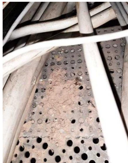
Billedet viser kiselgur i kabelbakke (Hjørne ved cykelindgang, kabel til ladestander)
